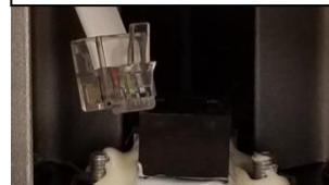
Câble de cellule de pesage non connecté
