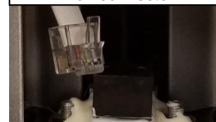
Câble de cellule de pesage non connecté
