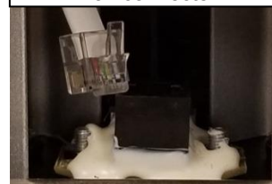
Câble de cellule de pesage non connecté
