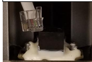
Câble de cellule de pesage non connecté
