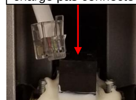
Câble de cellule de charge pas connecté
