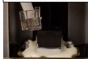
Câble de cellule de pesage non connecté
