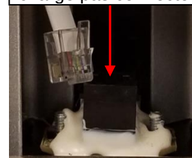
Câble de cellule de charge pas connecté
