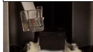
Câble de cellule de pesage non connecté
